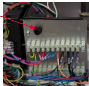
Interruptor de restablecimiento LC3 de Photon 25-100
