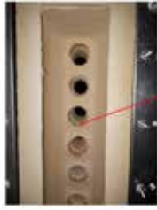
Geen spleet tussen buisinzetstuk en kamerisolatie
